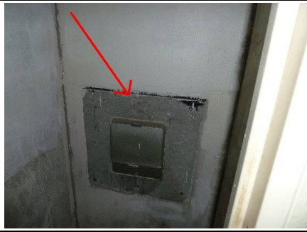
Photo n° PH03 Localisation : Étage 1 - Local poubelle Ouvrage : Local poubelle Partie d'ouvrage : Plaque de protection Description : Plaque fibre ciment
