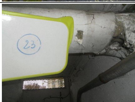
Photo n° PH05 Localisation : RDCH - Cave Ouvrage : Équipements divers et accessoires - Tuyauteries Partie d'ouvrage : Calorifugeages Description : Calorifugeages Localisation sur croquis : PH05
