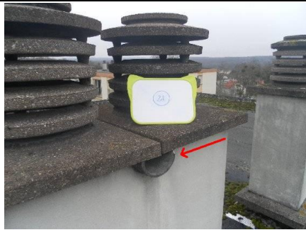
Photo n° PH02 Localisation : Toiture - Terrasse Ouvrage : Conduits, canalisations et accessoires intérieurs et extérieurs - Conduits de fluides (air, eau, vapeur, fumée, autres fluides) Partie d'ouvrage : Canalisation Description : Canalisation d'évacuation
